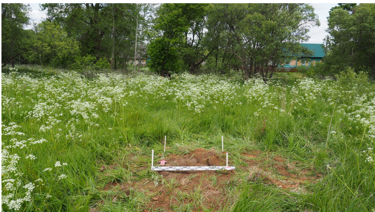
Рис. 41. Калужская область, Спас-Деменский район. 2023 г. Археологическое обследование по объекту: «Уличные газопроводы дер. Жданово». Шурф 2 после засыпки. Вид с юга.
